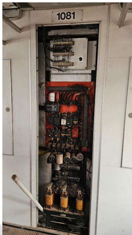
Figura 5 - Painel elétrico de trem da Série 1000, onde ocorreram os incêndios.
